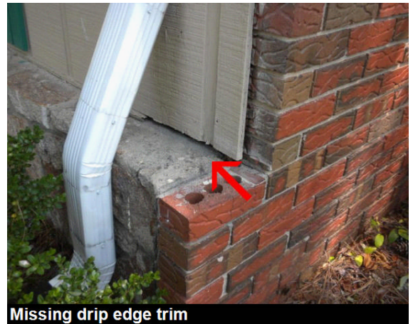
Missing drip edge trim
